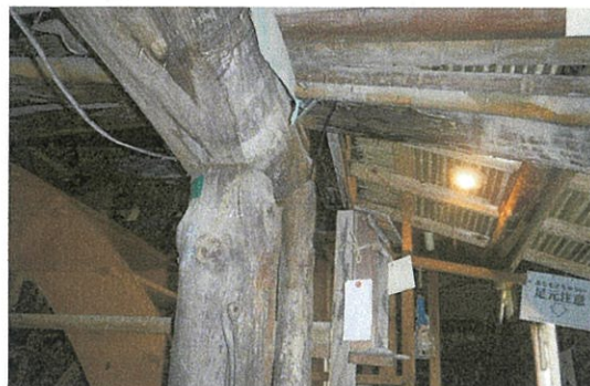
水車場内部照明 水輪部分
